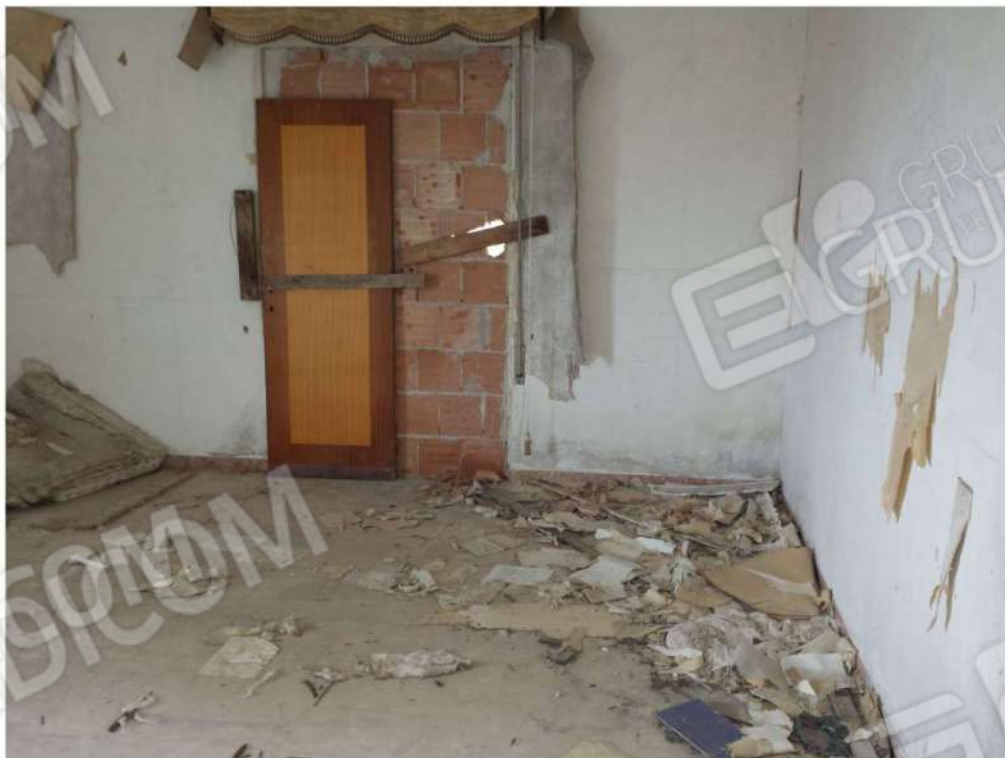
Foto n. 156: Balcone murato che consentiva l'accesso alla terrazza esterna ubicata al primo piano (secondo fuori terra) dell'immobile sito nel comune di Maida (lotto n. 6).
