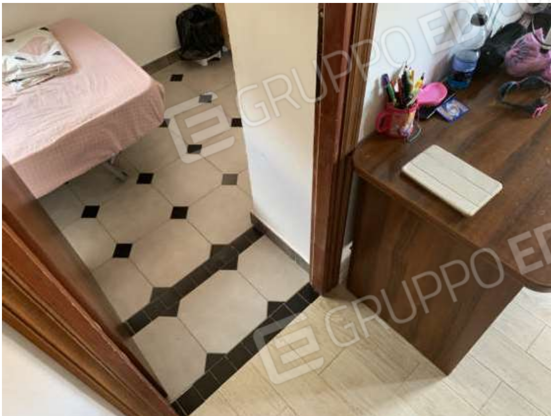
Foto N. 15: Lotto B – Particolare della camera verso l'ampliamento oggetto di opere di demolizione e ripristino
