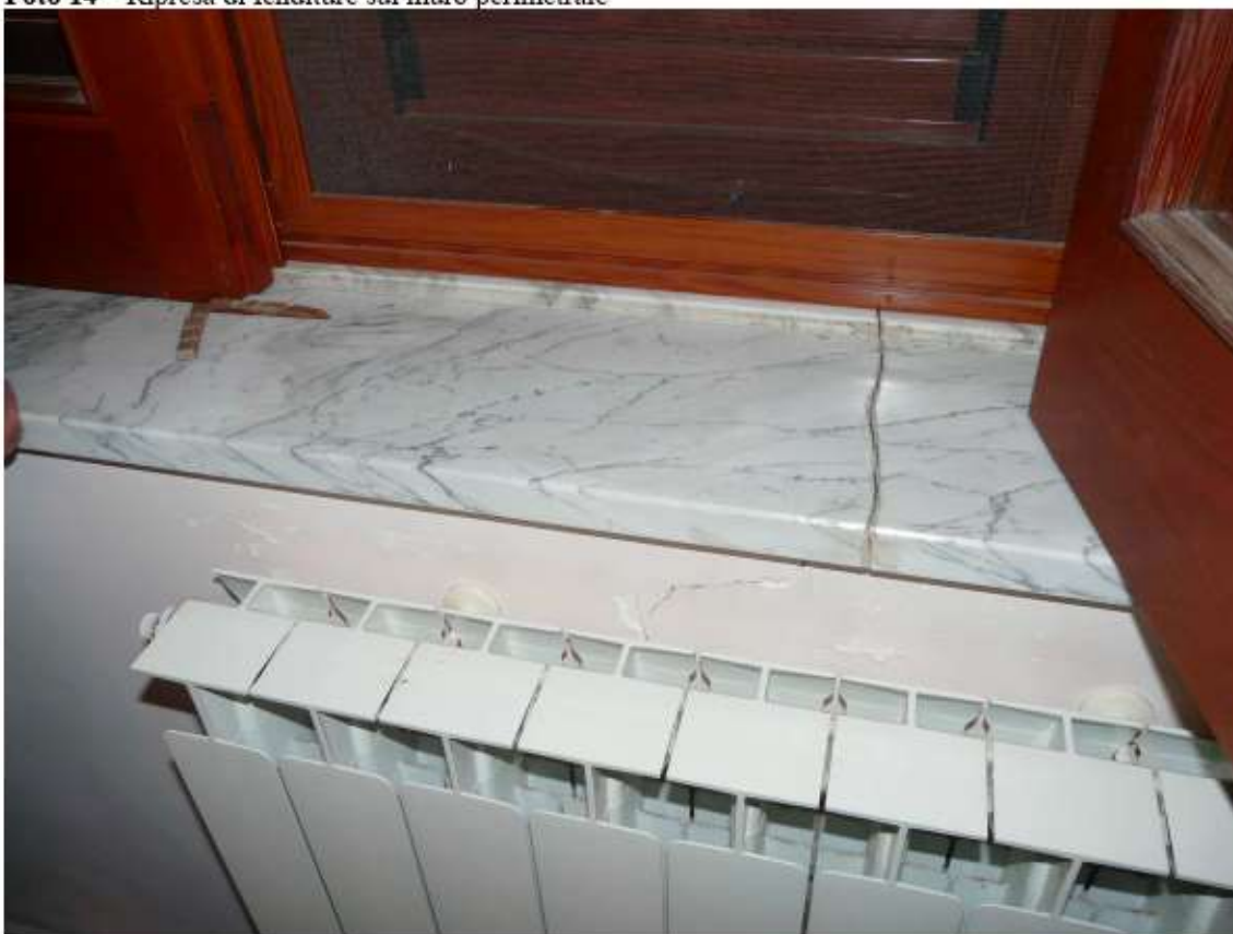
Foto 14 – Ripresa di fenditure sul muro perimetrale
