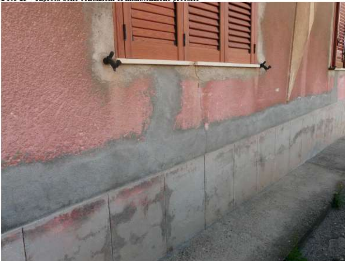
Foto 13 – Ripresa delle condizioni di manutenzione precarie
