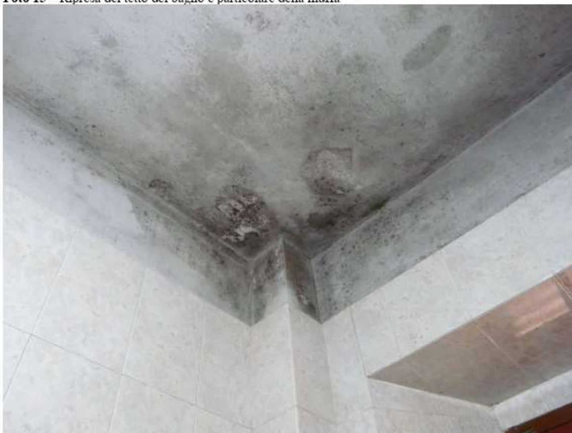
Foto 15 – Ripresa del tetto del bagno e particolare della muffa
