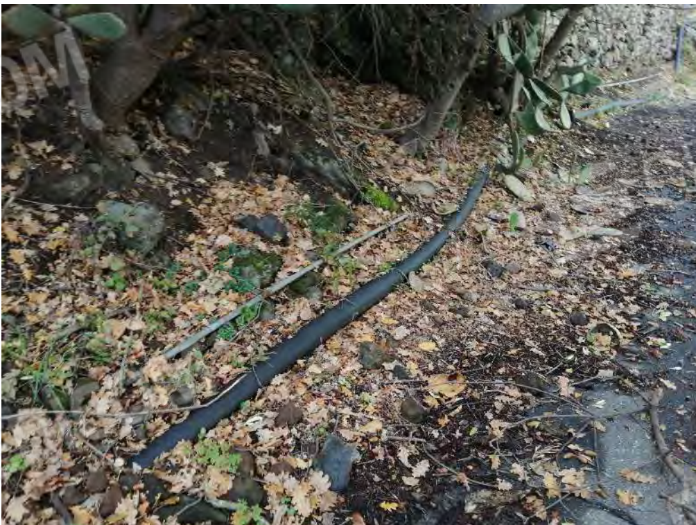
FO-24 TUBAZIONE PRINCIPALE DEL SISTEMA IRRIGUO IN DISUSO
