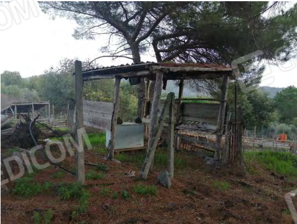
FO-46 STRUTTURE PRECARIE PRESENTI SU PARTICELLA 485 FOGLIO 34
