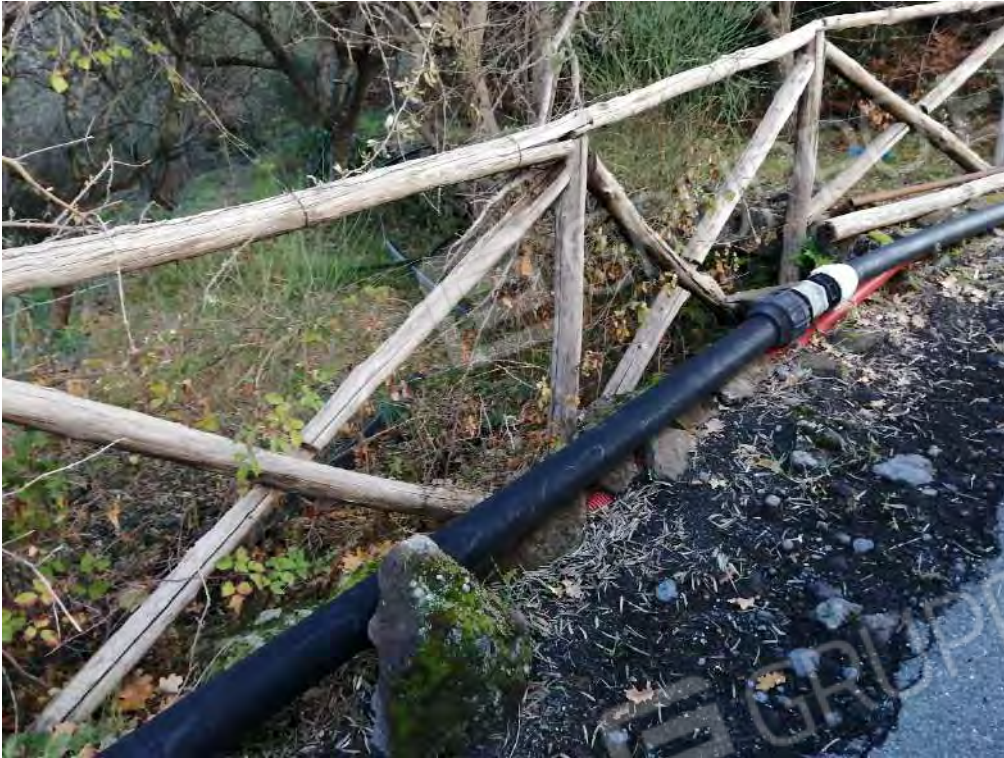
FO-25 TUBAZIONE PRINCIPALE DEL SISTEMA IRRIGUO IN DISUSO
