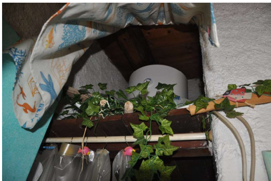
Particolare del boiler nel locale Wc
